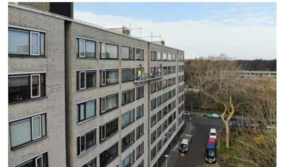
De bestaande ramen worden vervangen door nieuwe kant-en-klare exemplaren, uitgerust met hoogrendementsglas. Ook de voordeuren worden vernieuwd.
