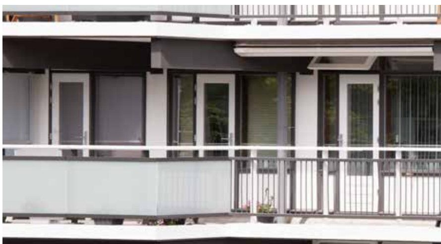
Ook de panelen waren aan vervanging toe. Een asbestspecialist verwijderde de originele panelen en Verweij zorgt voor de plaatsing van nieuwe isolatie en panelen.
